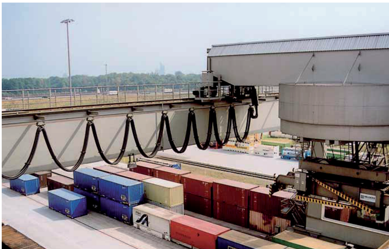
Leitungswagenanlage an einem Containerkran
